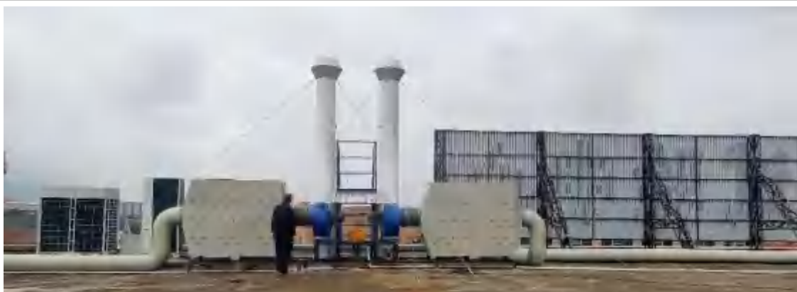
废气处理装置及排气筒（右）
