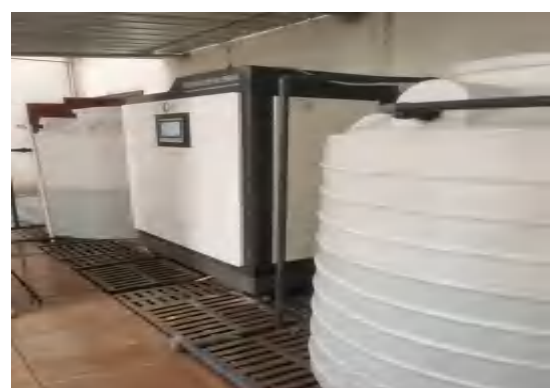
实验室污水处理设备
